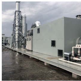
中山据点VOC处理装置
