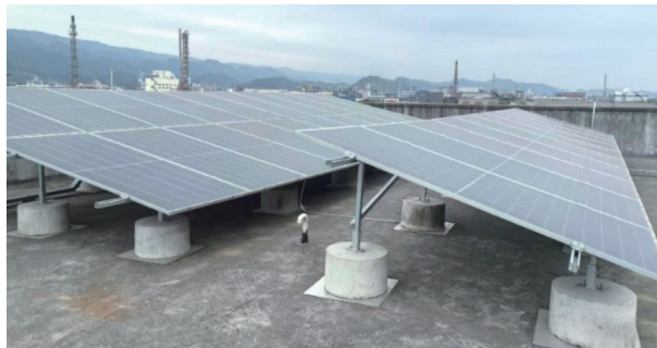
重庆据点自2025年11月起投入运行的太阳能发电系统
