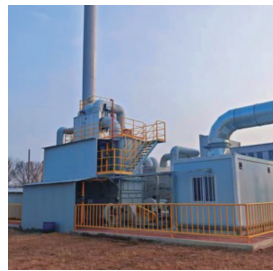
天津据点VOC处理装置
